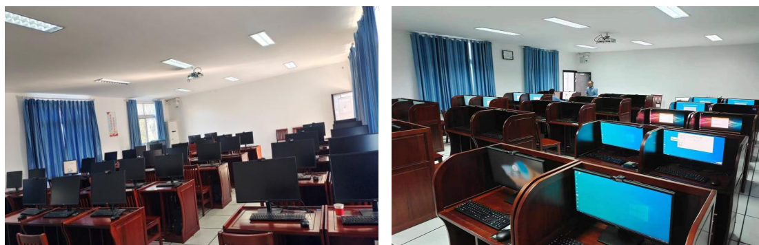
图 7 巴陵石化公司党校仿真教室机房
