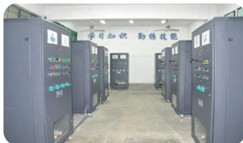
机床电路排故实训室
